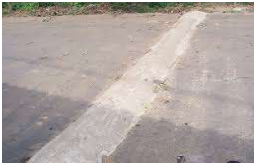
Rubber Speed Bump yang Tidak Sesuai Standar
